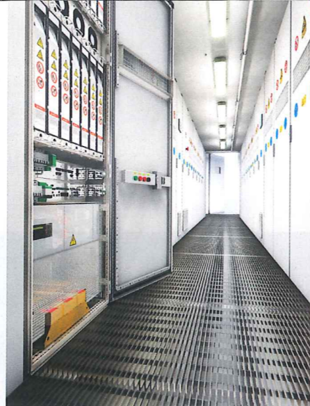
Lithium-Ionen-Speicher „Siestorage“ von Siemens: Platz in einem Transportcontainer
